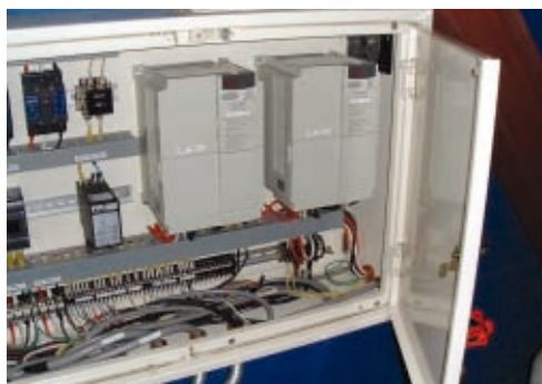
浜松工場の上水ポンプ制御盤に取り付けられたインバーター装置
