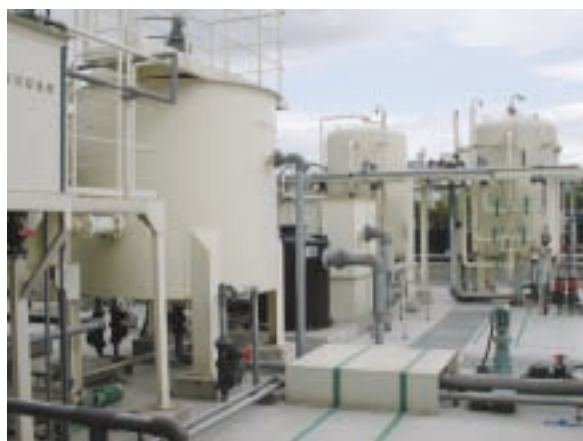
藤沢工場の総合排水処理センター
