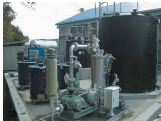
藤沢製作所の土壌 / 地下水 浄化設備
