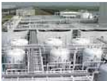
中国 / 上海工場の廃水処理施設
